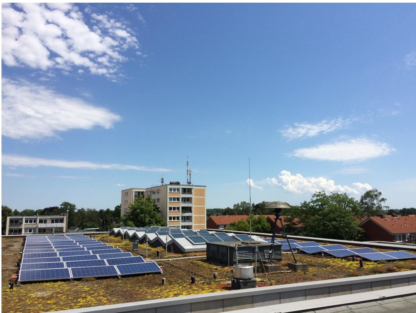
Die Fotovoltaikanlage auf dem Rathaus in Hemmingen.
