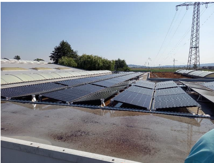
Ein Teil der 96 kWp Solarstronanlage
