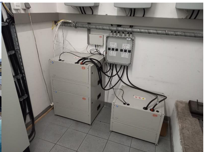
Der 46 kW Speicher
